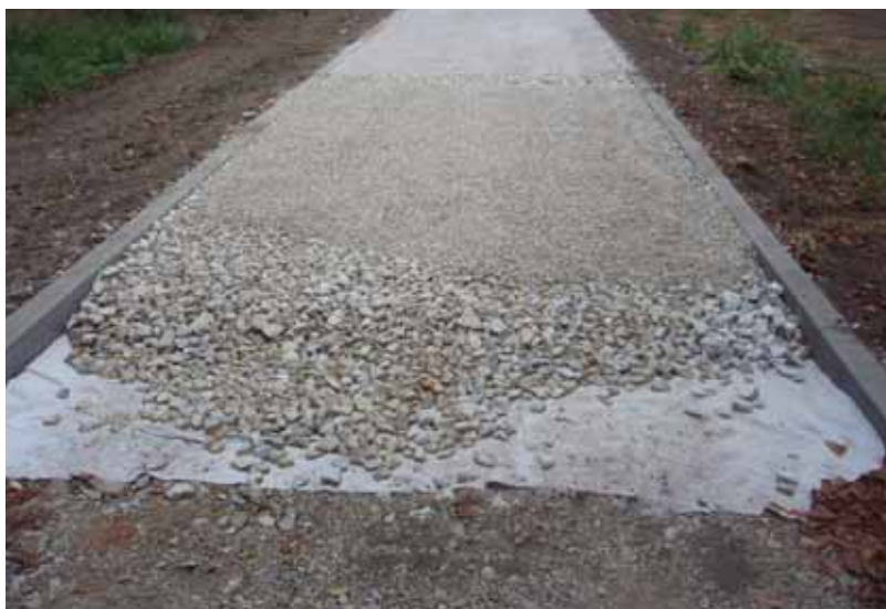
Šachta kanalizácie v trase komunikácie odkrytá pri výkope a skúška profilu komunikácie Kanalizációs sakta a földmunkálatok megkezdésekor és a kommunikáció profiljának próbája.
